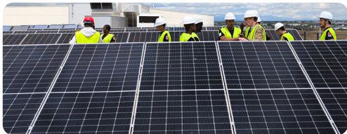
Cubierta Solar Fotovoltaica
